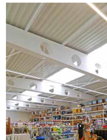
„TopHaus“ Baumarkt, Brixen: Die Klimadecke temperiert den bis zu 7,5 Meter hohen Raum gleichmäßig und effizient. Selbst im Rekordsummer 2015 genossen die Kunden und Mitarbeiter angenehm kühle Räume – bei Außentemperaturen über 35\text{ °C} .
