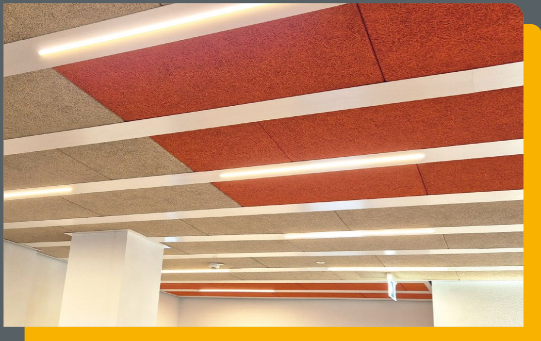
Klimadecke mit integrierter Beleuchtung
