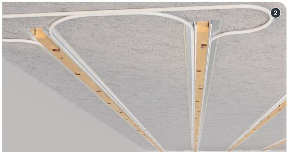
Verrohrung endlos vom Verteiler zum Verteiler
