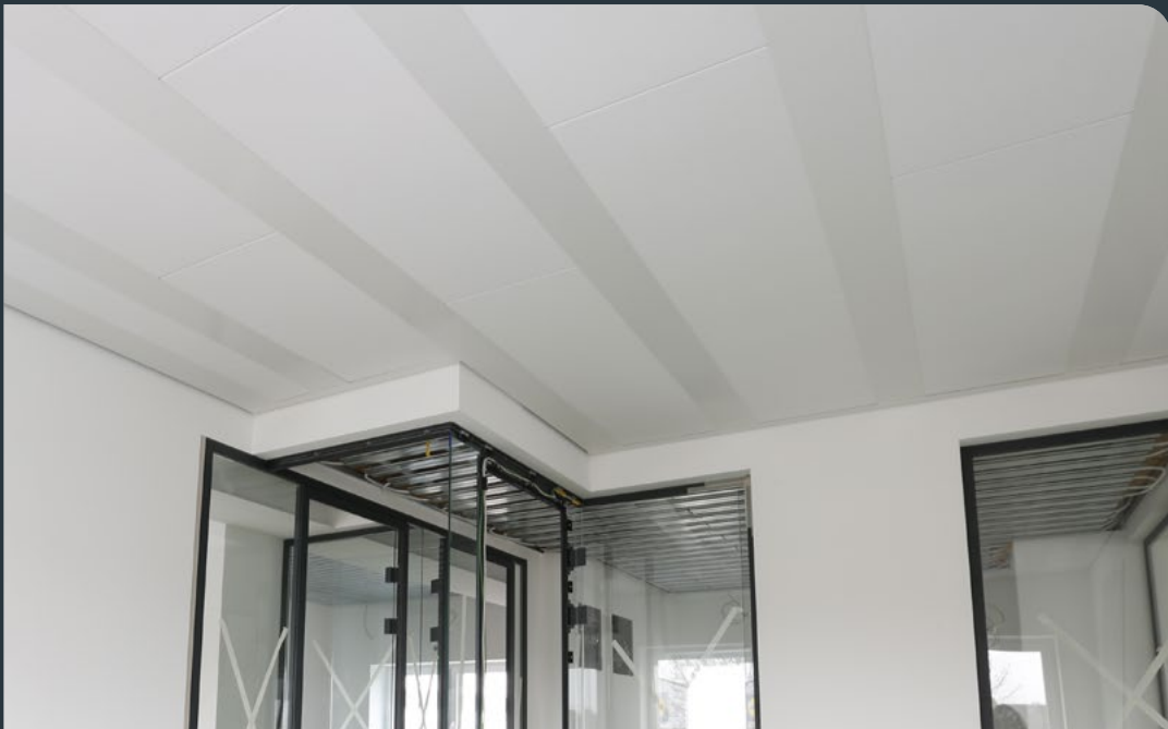
Klimadecke mit integrierter Beleuchtung
