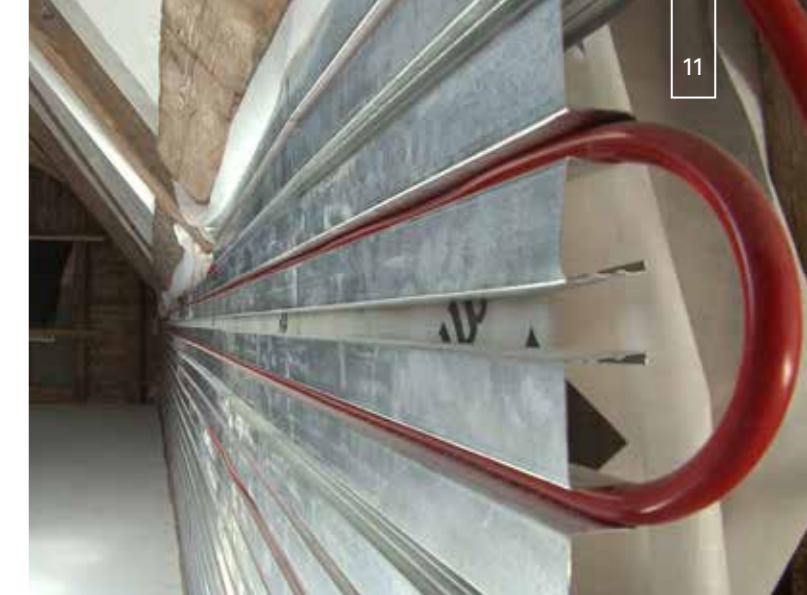
Wandflächen können mit demselben System zum Heizen und Kühlen genutzt werden.
